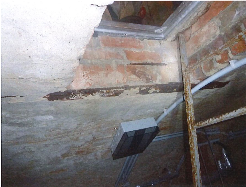
Ansicht eines der stark korrodierten Wechselträger am Einstieg zum Gruftvorraum
